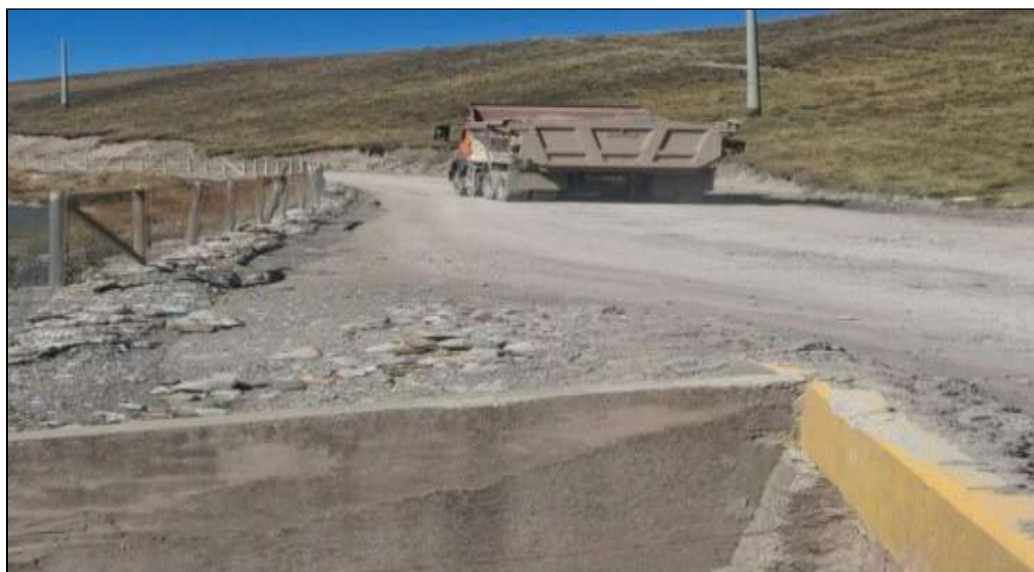
Imagen 13. Traslado de arena sin ninguna mediada ambiental
