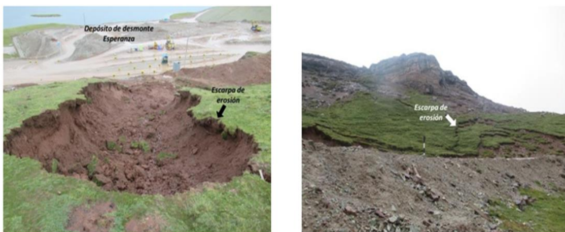
Figura 4. Fotografía de escarpas de erosión 1
