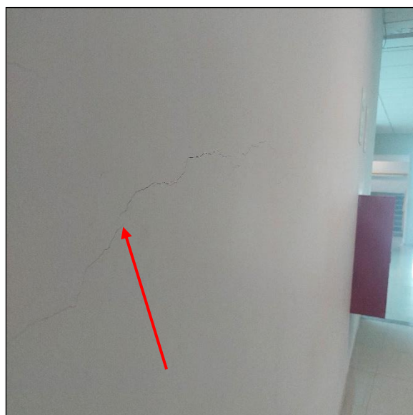
Imagen 2. Visualización de las fisuras longitudinales producidos en los muros divisorios.
