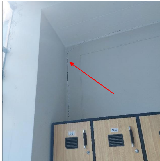
Imagen 1. identificación de las fisuras en la conexión de viga – columna.
