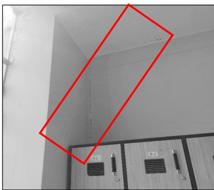
Figura 57. Grietas en muros divisorios.
