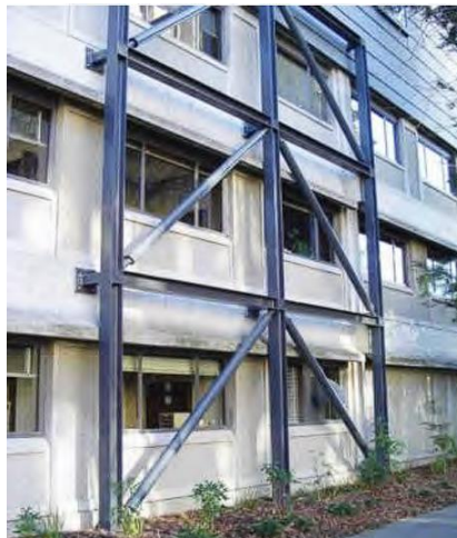
Figura 13. Arriostramiento metálico en edificio.
