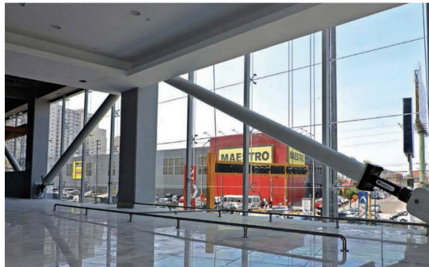
Figura 30. Uso de los disipadores de fluido viscoso en edificación nueva
