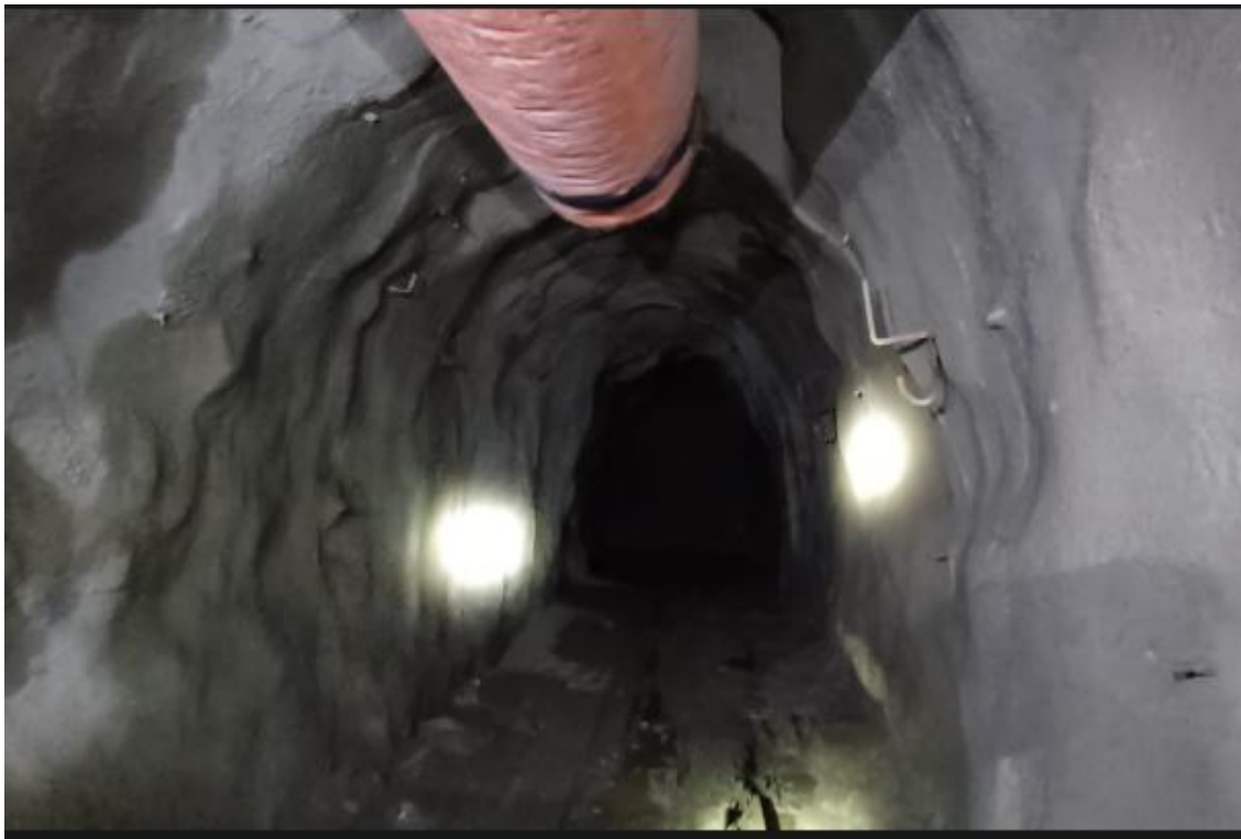
Figura 17 Galería 9888-S sostenida de acuerdo a la recomendación
