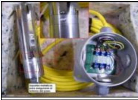
Geófono y Caja de Empalme
