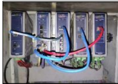
Gabinete de la Estación Sísmica
