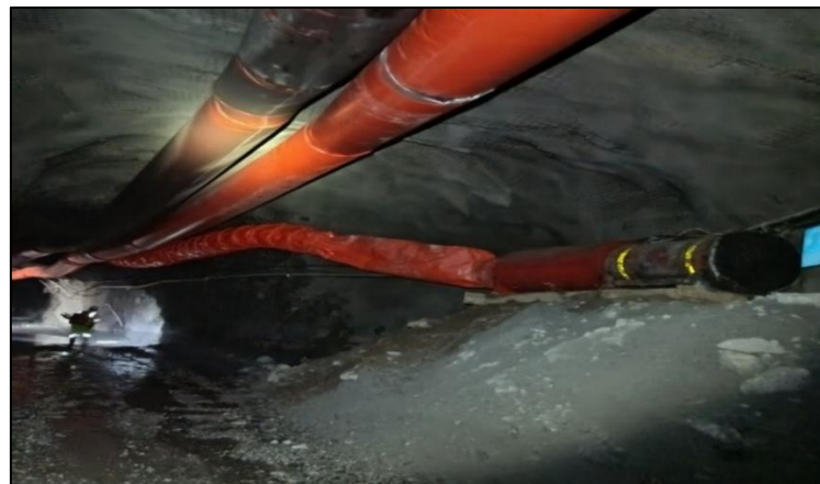
Figura 32 Serie de mangas de ventilación que proporcionan aire fresco.
