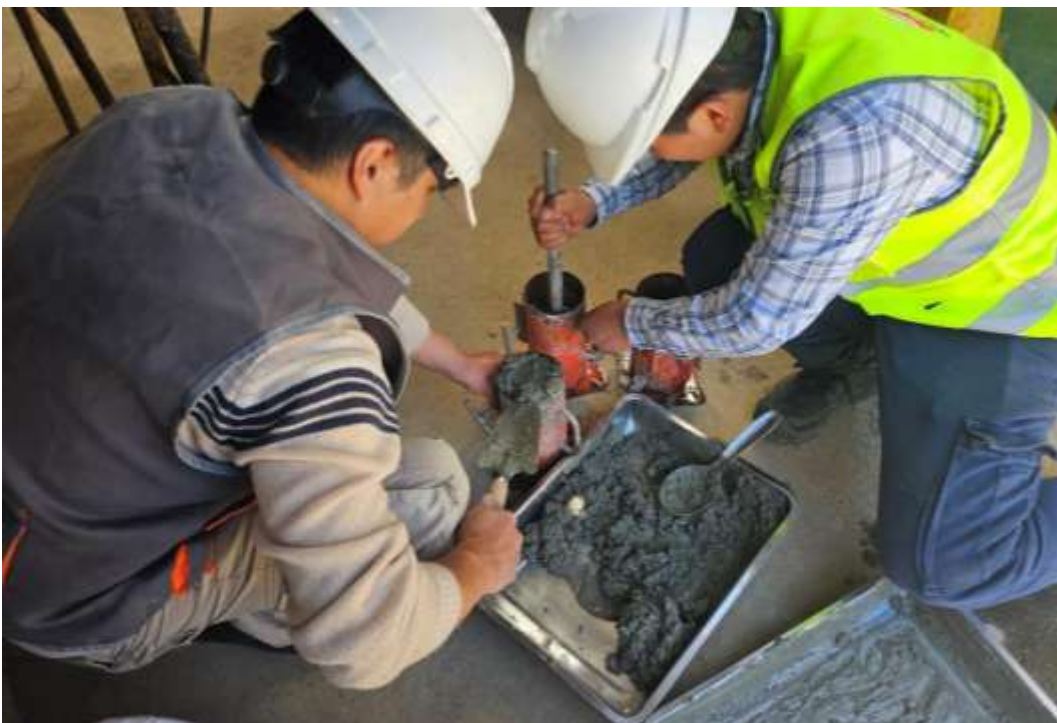
Fotografía 38. Se realiza el chuceado correspondiente al concreto en el molde, 25 golpes en 03 capas.
