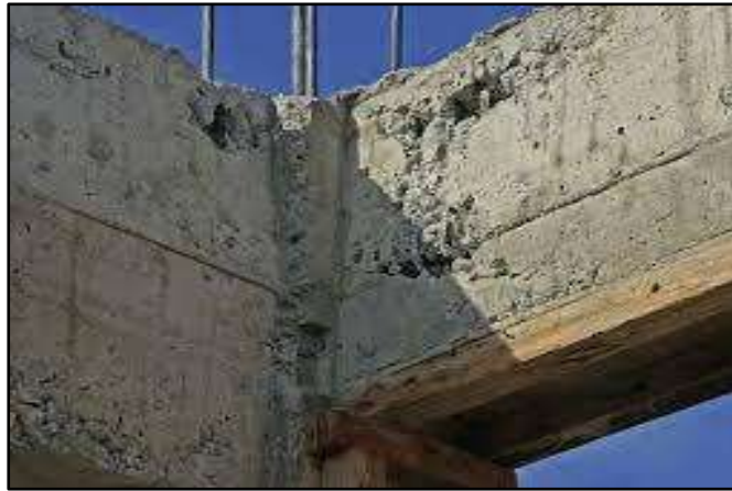
Figura 8. Resultado de la segregación del concreto
