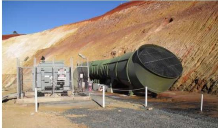
Figura 1. Ventilador Primario Extractor de Aire
