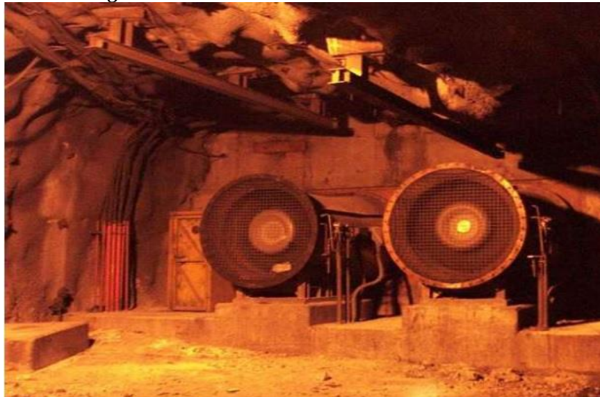
Figura 2. Dos Ventiladores Secundarios de Aire
