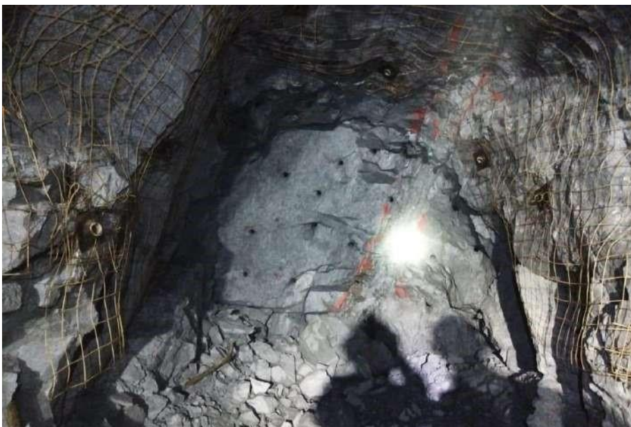
Anexo 17. Frente Perforado del SN 611 3W en Mineral y Sección de 1.8 m x 2 m
