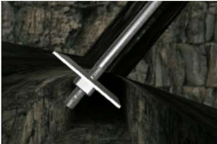
Figura 13 Mala colocación del perno
