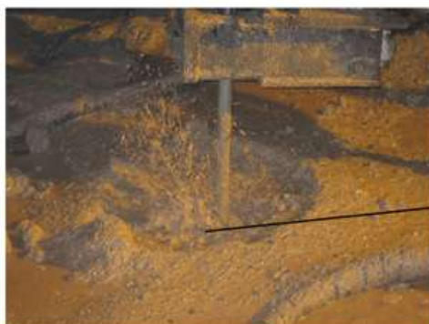
Figura 80 Mala limpieza de los taladros
