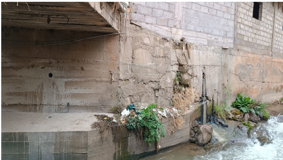
Figura 3. Estribo derecho con vivienda construida sobre alero.
