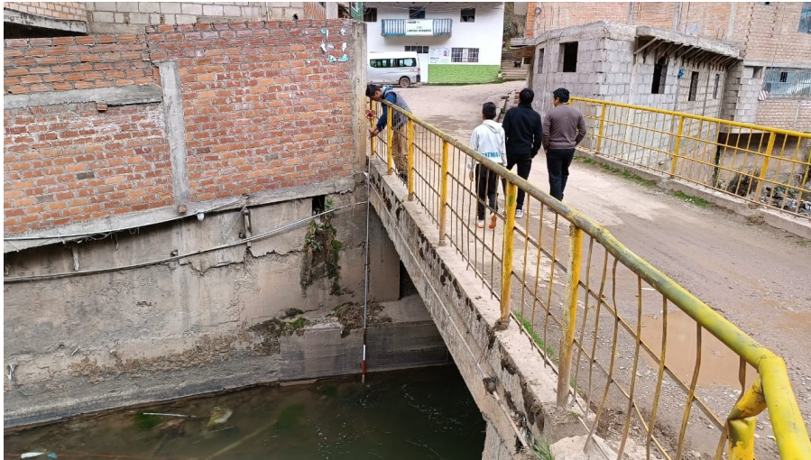
Figura 2. Estribo derecho con vivienda construida sobre alero.
