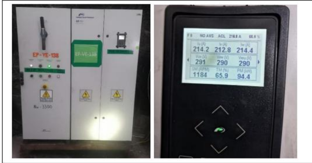
Figura 30. Display de programación, arranque automático y variador del ventilador principal EP-VE-138
