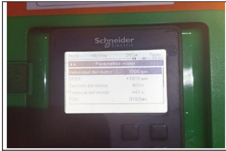
Figura 1. Variador process del ventilador EP-VE-106
