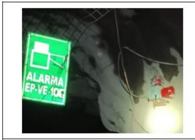
Figura 4. Dispositivo sonoro en caso de falla eléctrica y/o mecánica del ventilador EP-VE-106
