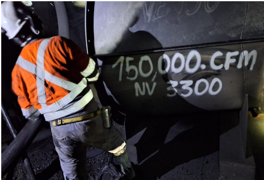
Fotografía 7: Registro de identificación de ventilador principal EP-VE-138 con su capacidad nominal de 150 000 CFM
