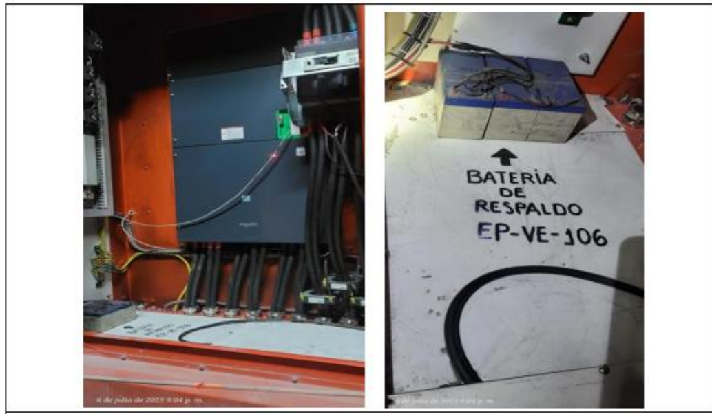
Figura 6. Baterías de respaldo del tablero arrancador EP-VE-106
