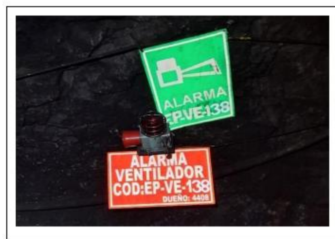
Figura 31. Dispositivo sonoro en caso de falla eléctrica y/o mecánica del ventilador EP-VE-138
