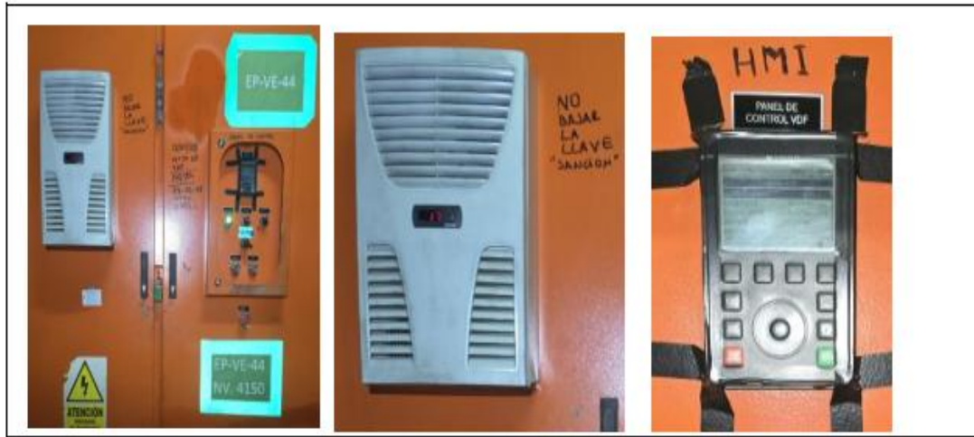
Figura 10. Display de programación, arranque automático y variador del ventilador principal EP-VE-44
