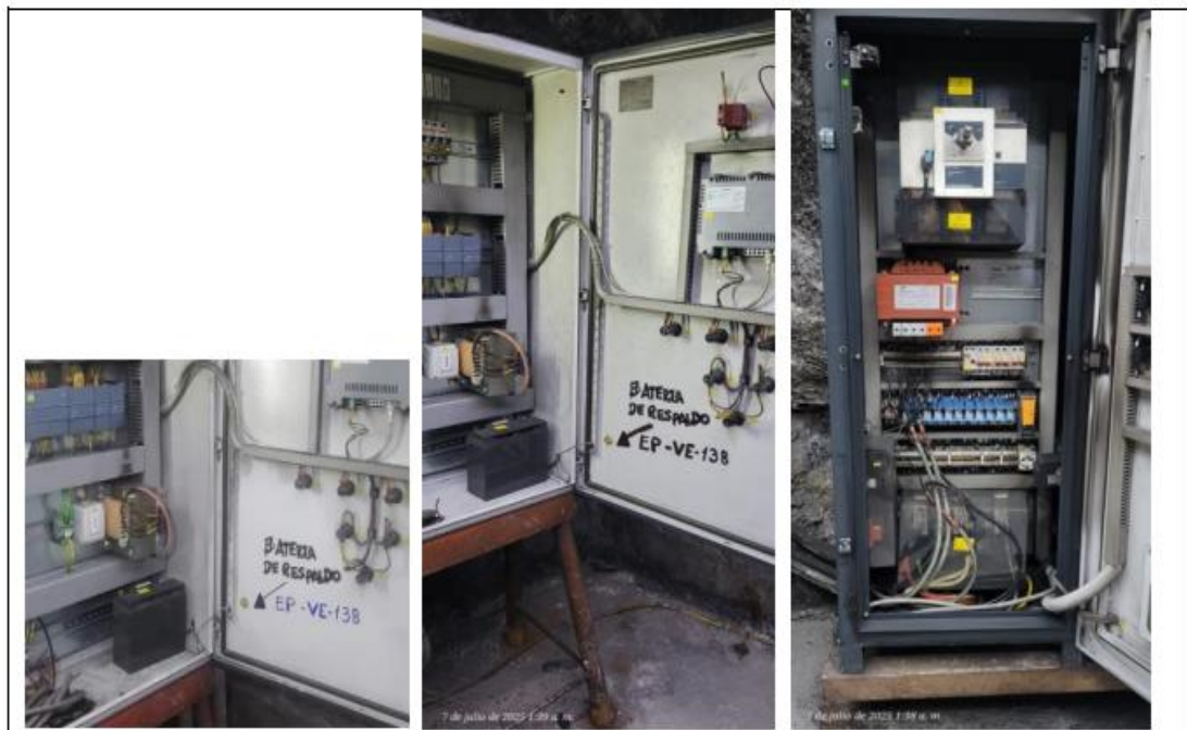
Figura 32. Baterías de respaldo del tablero arrancador EP-VE-138
