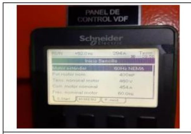
Figura 9. Panel de monitoero y operaciones en el variador del ventilador principal EP-VE-44
