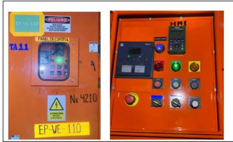
Figura 20. Display de programación, arranque automático del ventilador principal EP-VE-110
