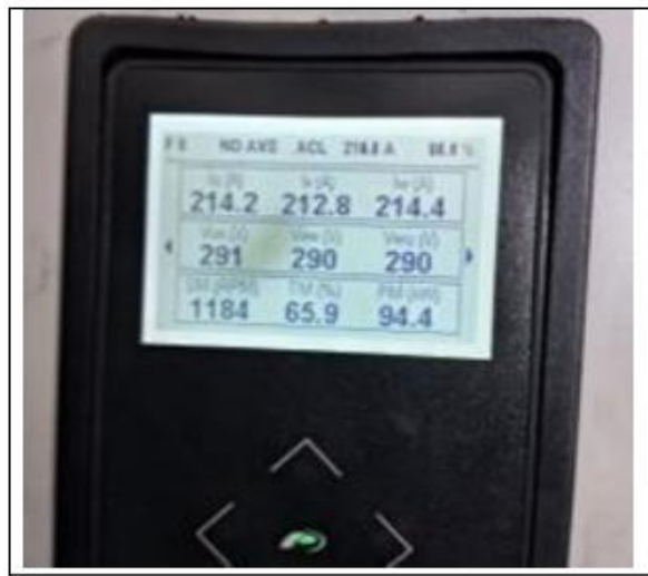
Figura 29. Panel de monitoreo y operaciones en el variador del ventilador principal EP-VE-138
