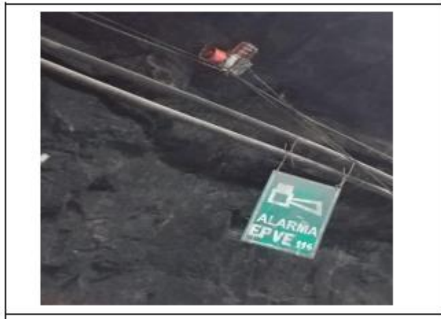
Figura 16. Dispositivo sonoro en caso de falla eléctrica y/o mecánica EP-VE-116
