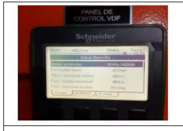
Figura 8. Panel de monitoreo y operaciones en el variador del ventilador principal EP-VE-44
