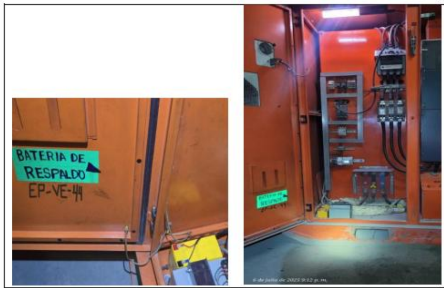
Figura 12. Baterías de respaldo del tablero arrancador del EP-VE-44
