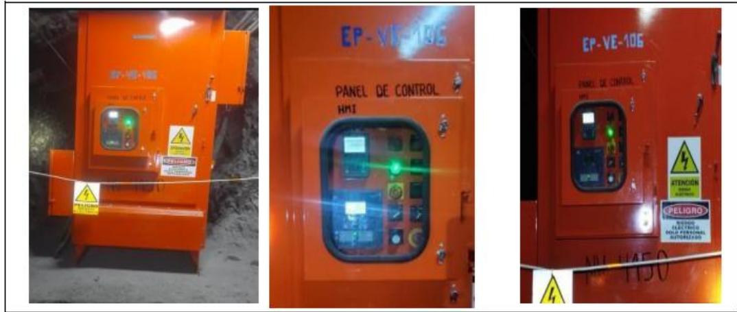
Figura 3. Display de programación, arranque automático y variador del ventilador principal EP-VE-106
