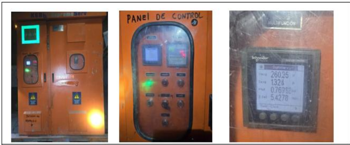
Figura 35. Display de programación, arranque automático del ventilador principal EP-VE-74
