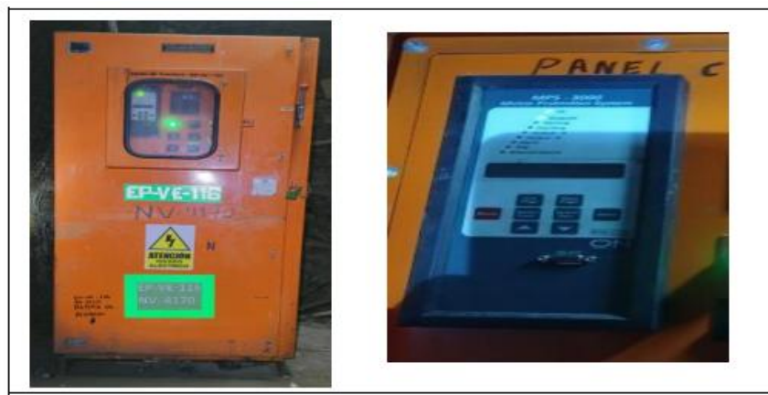
Figura 15. Display de programación, arranque automático del ventilador principal EP-VE-116
