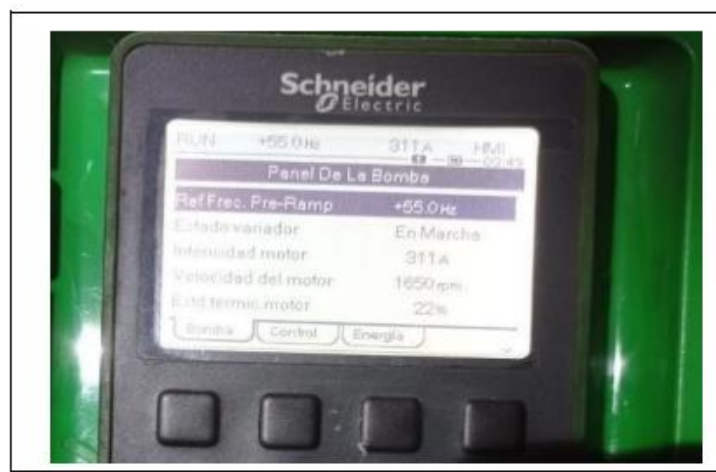
Figura 2. Panel de monitoreo y operaciones en el variador del ventilador principal EP-VE-106
