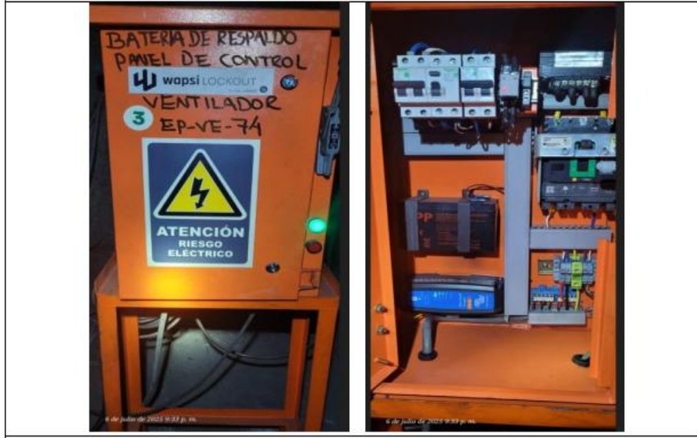
Figura 38. Baterías de respaldo de panel de control de EP-VE-74
