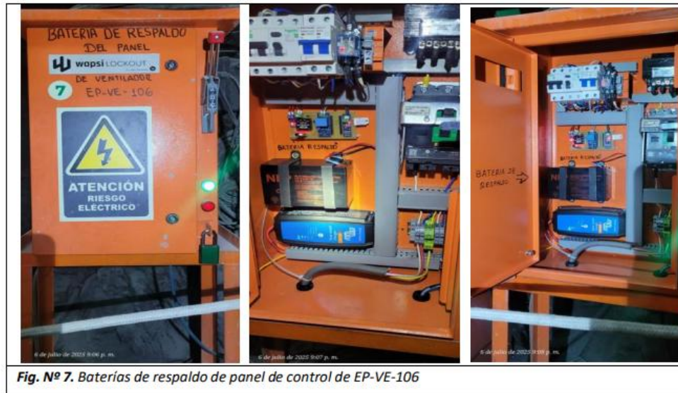
Figura 7. Baterías de respaldo del panel de control de EP-VE-106
