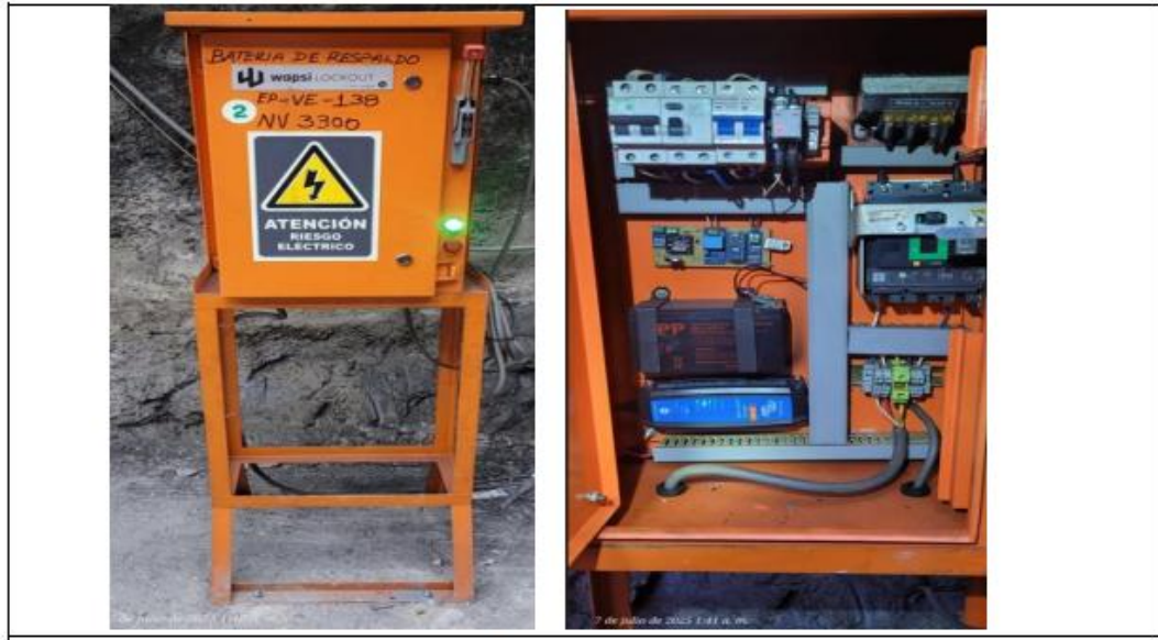
Figura 33. Baterías de respaldo de panel de control de EP-VE-138
