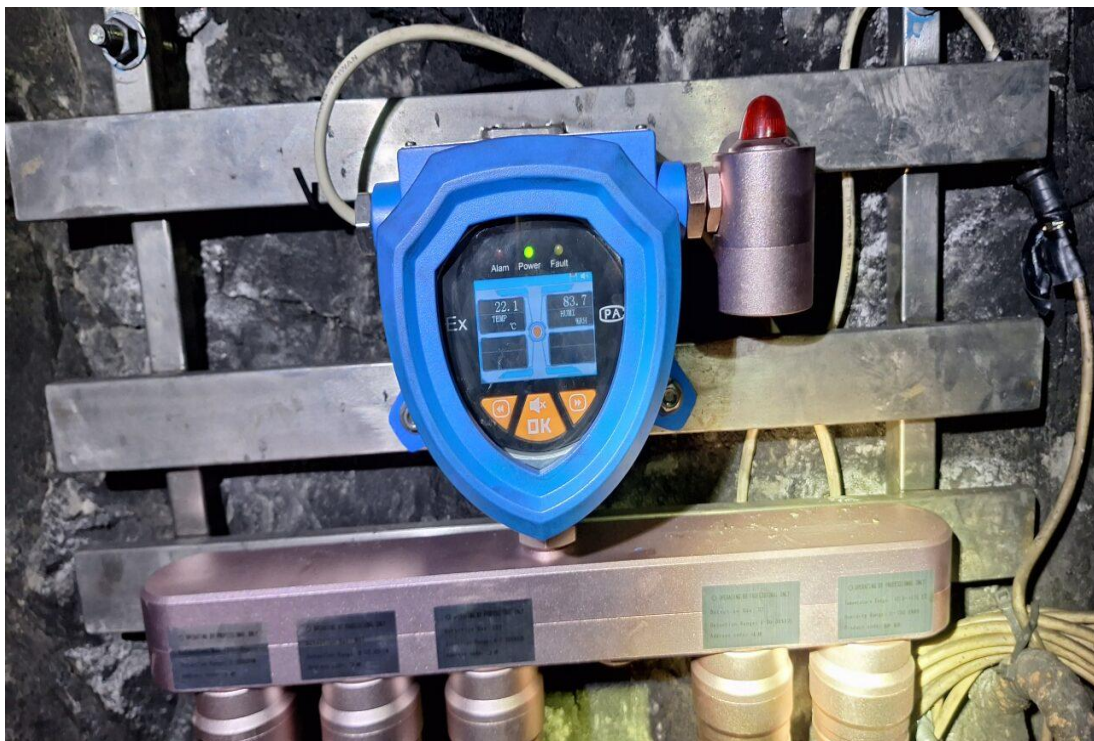
Fotografía 8: Módulo WAPSI de detección de gases instalado en interior mina, conectado al sistema de monitoreo en tiempo real
