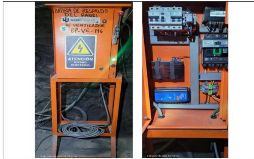
Figura 18. Baterías de respaldo de panel de control de EP-ve-116
