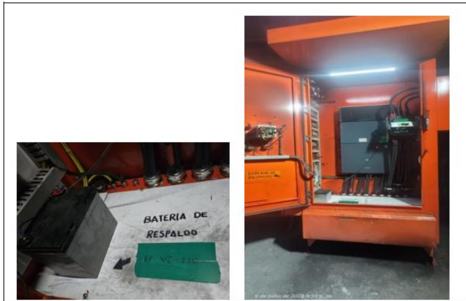
Figura 22. Baterías de respaldo del tablero arrancador EP-VE-110
