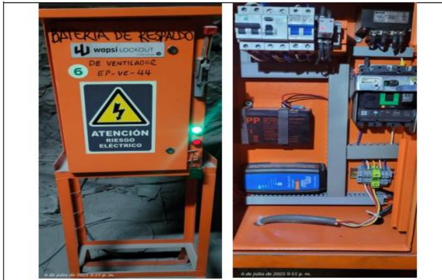
Figura 13. Baterías de respaldo de panel de control de EP-VE-44
