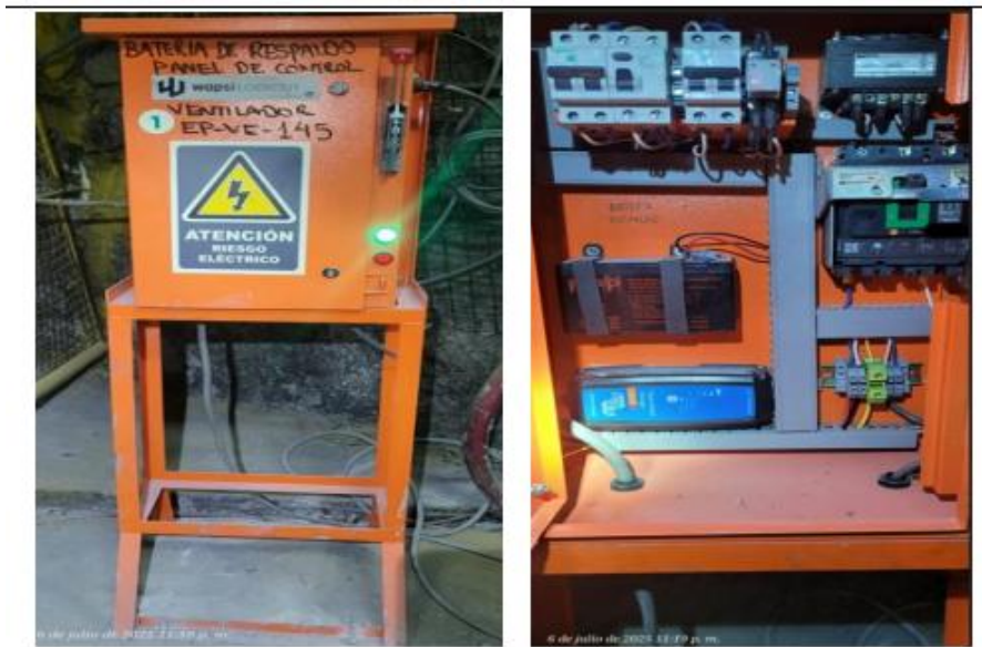
Figura 28. Baterías de respaldo de panel de control de EP-VE-145
