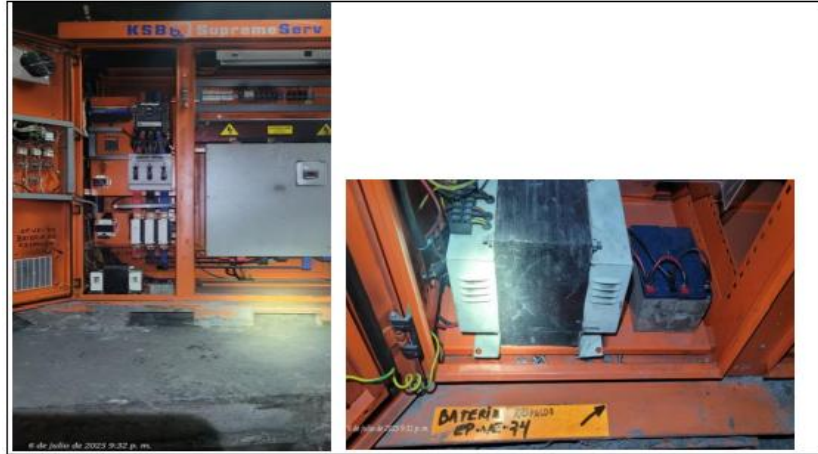
Figura 37. Baterías de respaldo del tablero arrancador EP-VE-74
