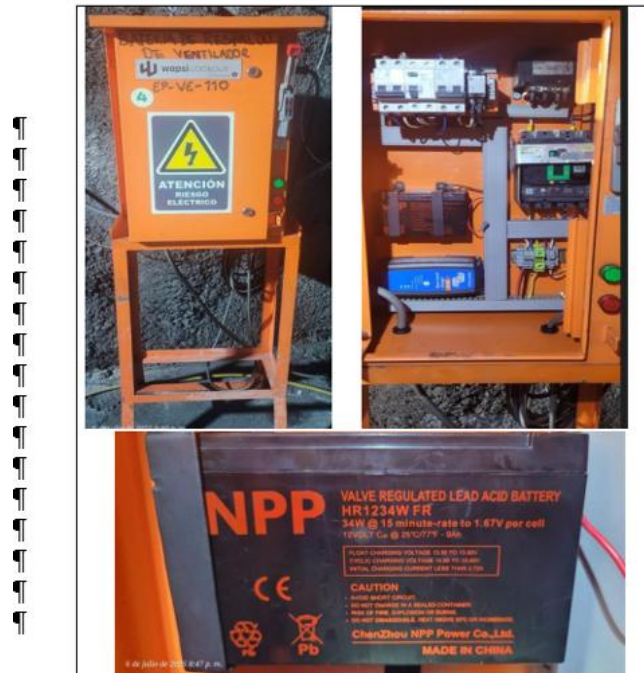
Figura 23. Baterías de respaldo de panel de control de EP-VE-110
