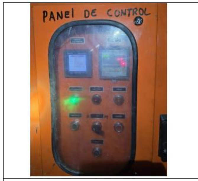
Figura 34. Panel de monitoreo operaciones en el SOFT STARTER del ventilador principal EP-VE-74
