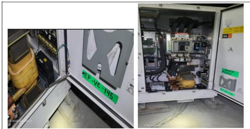
Figura 27. Baterías de respaldo del tablero arrancador EP-VE-145
