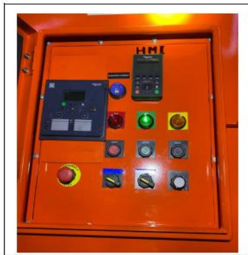
Figura 19. Panel de monitoreo operaciones en el variador del ventilador principal EP-VE-110
