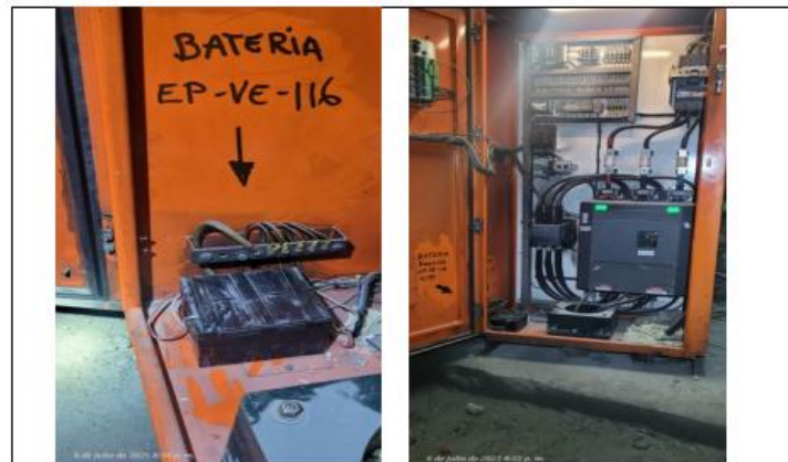
Figura 17. baterías de respaldo del tablero arrancador del EP-VE-116
