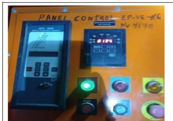
Fig. N° 14. Panel de monitoreo operaciones en el SOFT STARTER del ventilador principal EP-VE-116
