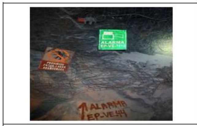
Figura 11. Dispositivo sonoro en caso de falla eléctrica y/o mecánica del ventilador EP-VE-44
