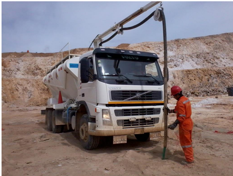
Camion fabrica cargando San – G
