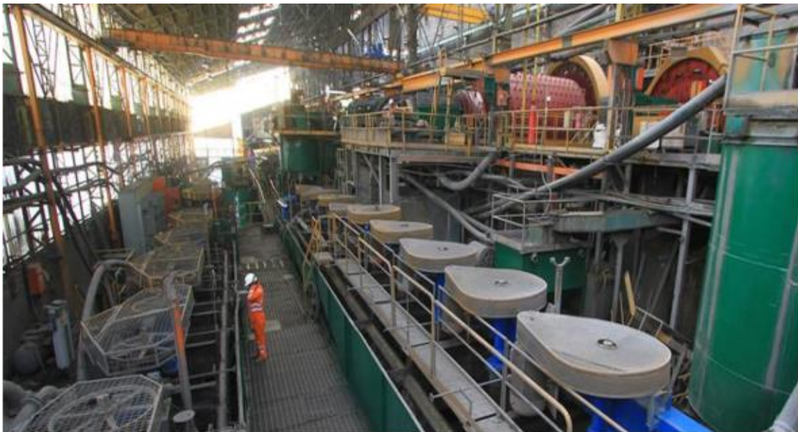
Fotografía 2. Circuito de flotación de la planta concentradora
