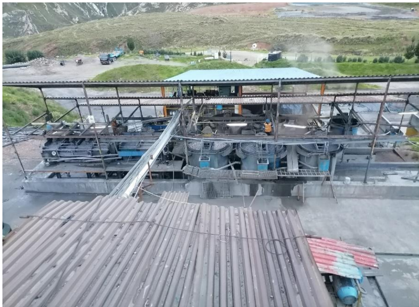
Planta Concentradora Sección Flotación
