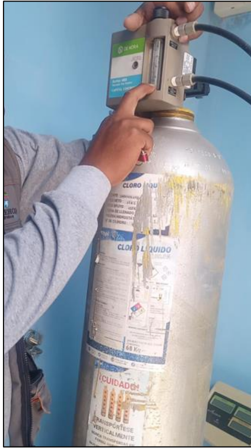
Imagen 7. Control del sistema de cloración automática
