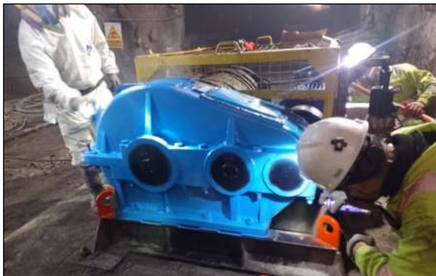
Ilustración 13. Inspección de winche Eléctrico
