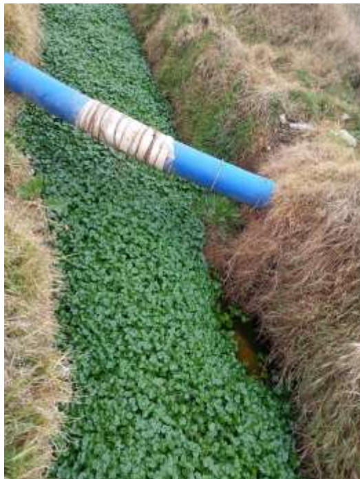
Foto 7: Tubería de desfogue
