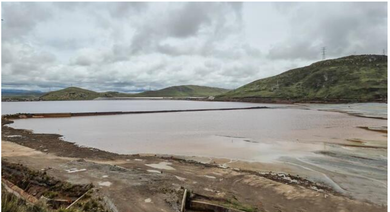
Fotografía N°6. Relave Quiulacocha en peligro de colapso por lluvias y granizadas (2022)
