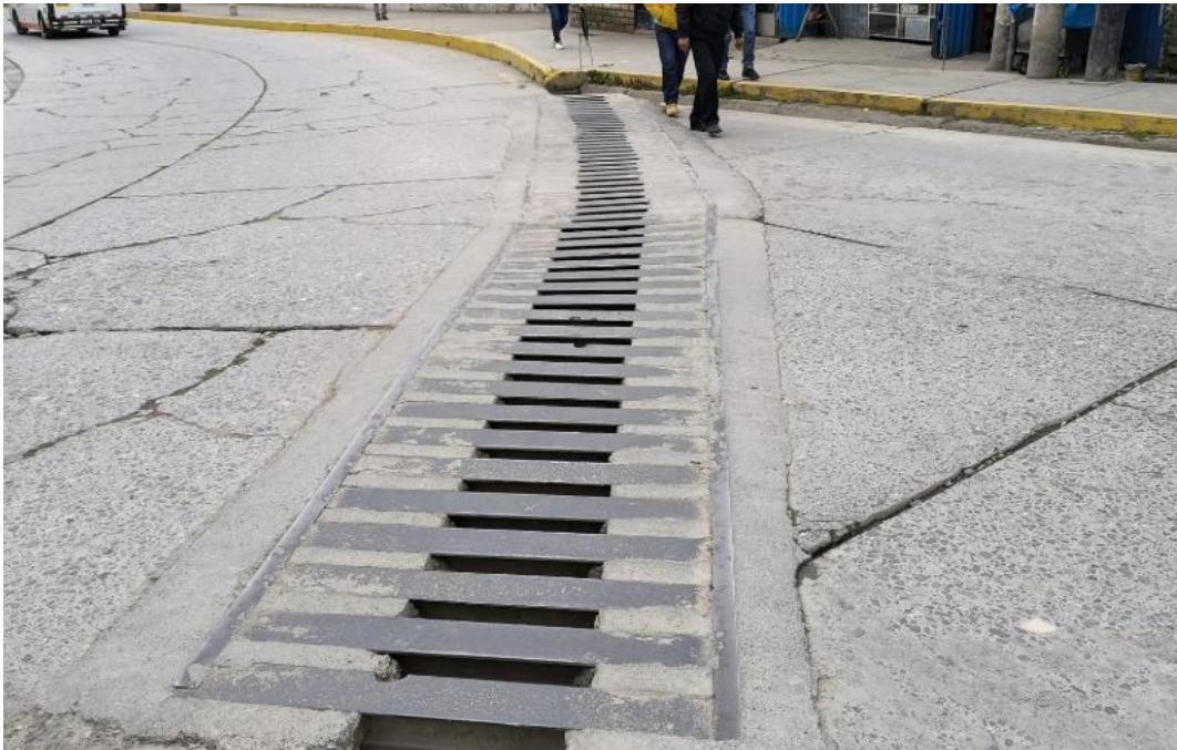
Ilustración 1: Sistema de drenaje construido y en buenas condiciones.
