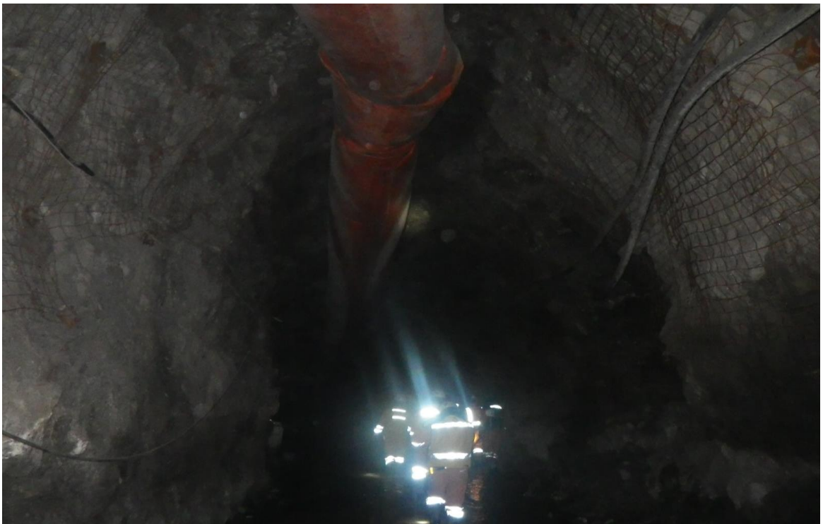
Fotografía N° 004: Vista del sistema de Ventilación
