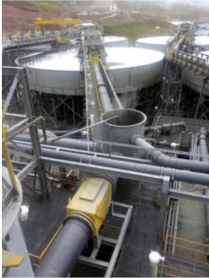
Fotografía 1. Cajón de mezcla colas Rougher
