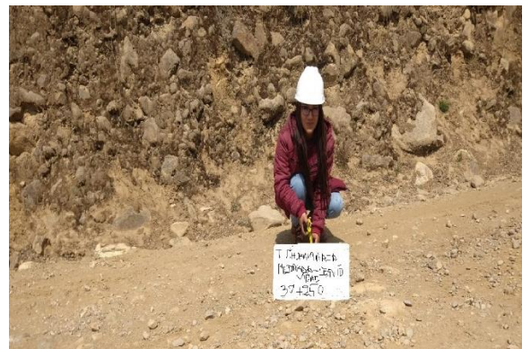
Foto N°22: Terreno prog: 30+250. La superficie de rodadura se ha deteriorado por erosión (entre 5 y 10 cm)
