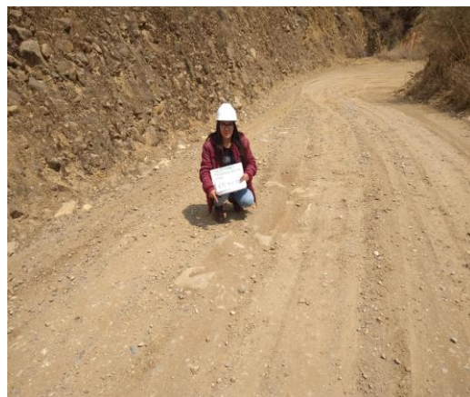
Foto N°14: Terreno prog: 10+750. La superficie de rodadura se ha deteriorado por encalaminado (mas de 10 cm)
