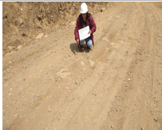
Foto N°3: Terreno prog: 0+500, La superficie de rodadura se ha deteriorado por encalaminado (mas de 10 cm)
