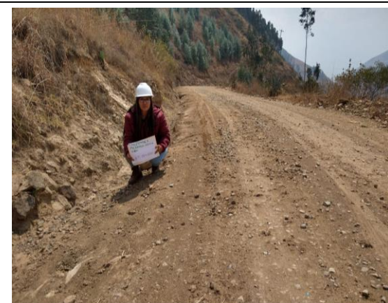
Foto N°5: Terreno prog: 1+000, La superficie de rodadura se ha deteriorado por encalaminado (mas de 10 cm)
