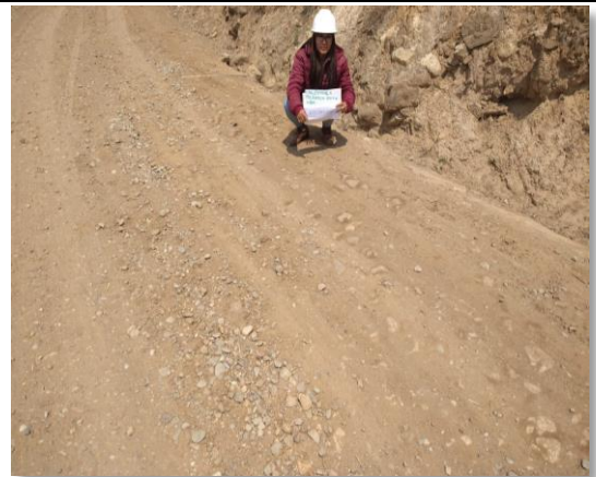
Foto N°2: Terreno prog: 0+250, se observa el deterioro del camino vecinal con presencia de encalaminado
