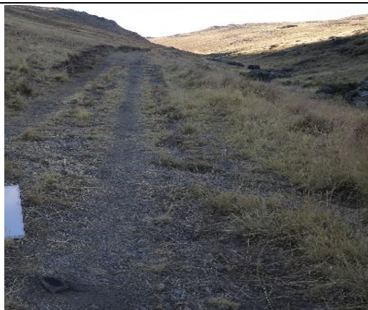
Foto N°18: Terreno prog: 20+250. La superficie de rodadura se ha deteriorado por encalaminado (mas de 10 cm)
