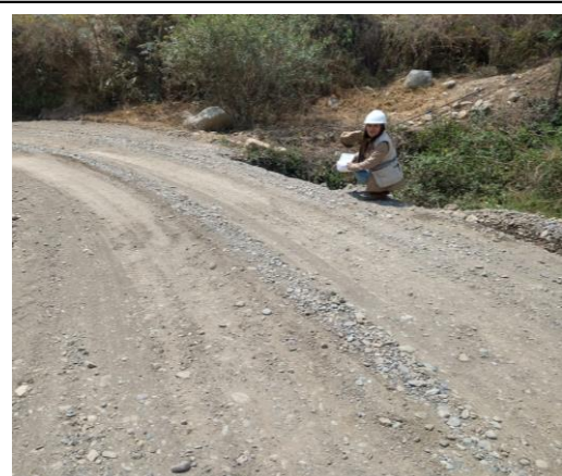
Foto N°16: Terreno prog: 16+250. La superficie de rodadura se ha deteriorado por encalaminado (mas de 10 cm)
