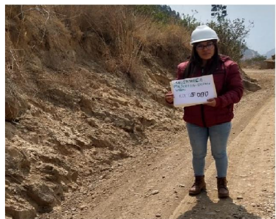
Foto N°11: Terreno prog: 5+000. La superficie de rodadura se ha deteriorado por deformación (entre 5 y 10 cm)
