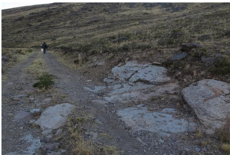
Figura N° 14 Superficie de rodadura deteriorado por erosión (entre 5 y 10 cm) progresiva 9+500km
