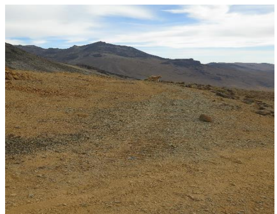
Foto N°12: Terreno prog: 5+250. La superficie de rodadura se ha deteriorado por deformación (entre 5 y 10 cm)
