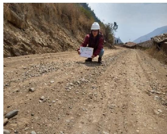
Foto N°10: Terreno prog: 4+750. La superficie de rodadura se ha deteriorado por deformación (entre 5 y 10 cm)
