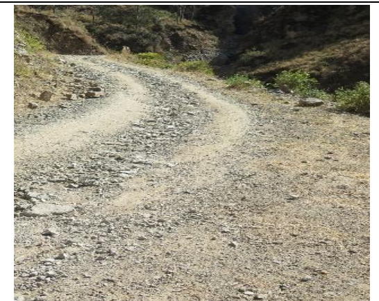
Foto N°6: Terreno prog: 1+250, se observa el deterioro del camino por erosion, el cual ha llegado a nivel de sub rasante
