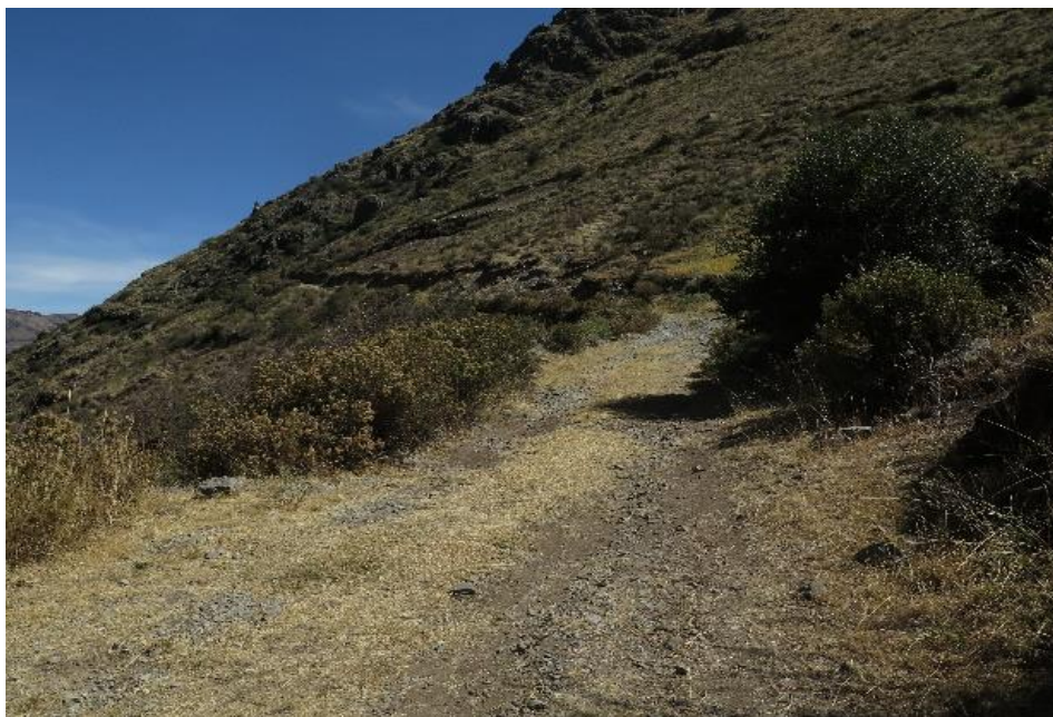
Figura N° 13 Superficie de rodadura deteriorada por deformación (entre 5 y 10 cm), progresiva 6+000km
