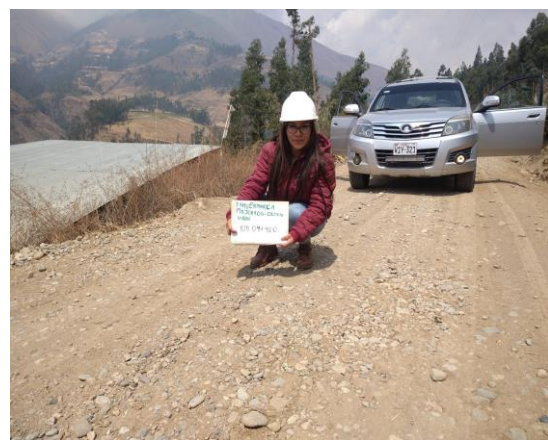
Foto N°9: Terreno prog: 4+460. La superficie de rodadura se ha deteriorado por erosión (entre 5 y 10 cm)
