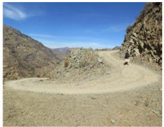
Foto N°8: Terreno prog: 3+250. La superficie de rodadura se ha deteriorado por encalaminado (mas de 10 cm)
