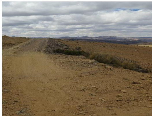
Foto N°21: Terreno prog: 30+000. La superficie de rodadura se ha deteriorado por encalaminado (mas de 10 cm)
