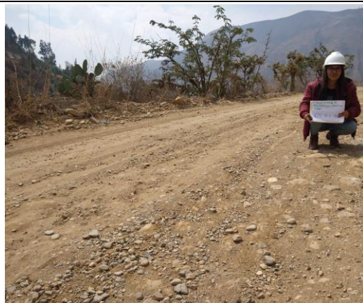
Foto N°13: Terreno prog: 10+500. La superficie de rodadura se ha deteriorado por encalaminado (mas de 10 cm)
