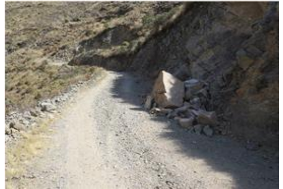
Foto N°20: Terreno prog: 25+750. La superficie de rodadura se ha deteriorado por encalaminado (mas de 10 cm)
