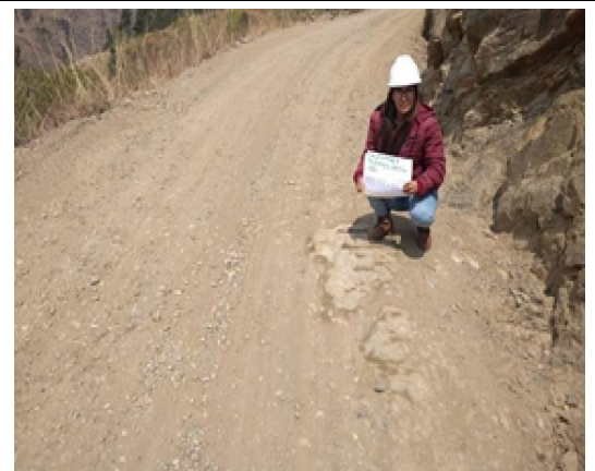
Foto N°4: Terreno prog: 0+750, La superficie de rodadura se ha deteriorado por erosión (entre 5 y 10 cm)
