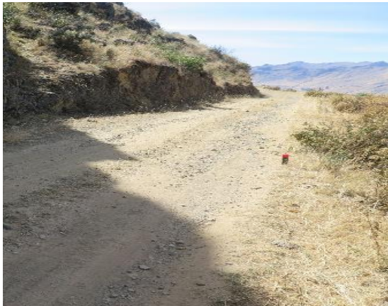
Foto N°7: Terreno prog: 2+300. La superficie de rodadura se ha deteriorado por erosión (entre 5 y 10 cm)
