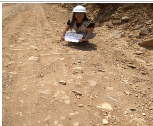
Foto N°17: Terreno prog: 20+000. La superficie de rodadura se ha deteriorado por erosión (entre 5 y 10 cm)
