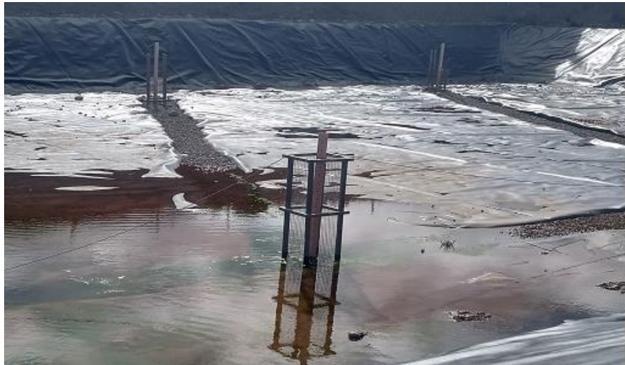
Imagen 20 Vista de drenes y chimeneas de evacuación y control de gases.
