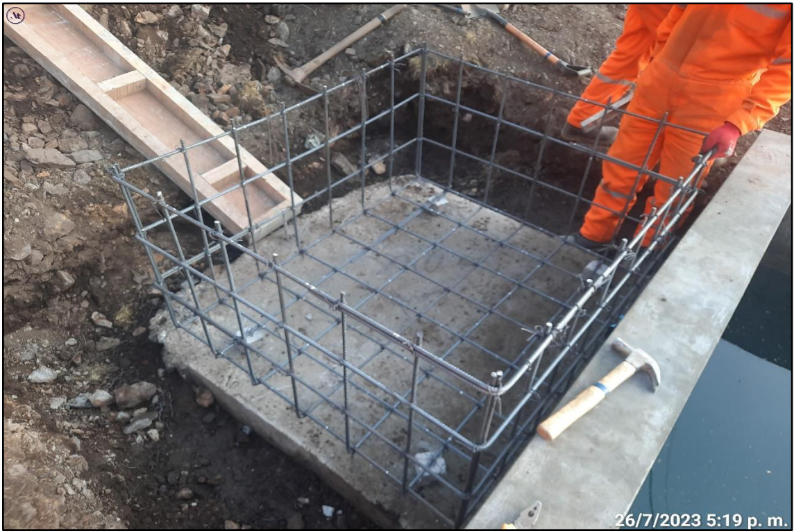
Anexo 42: Registro fotográfico de trabajos de colocación de acero en la caja de válvulas.
