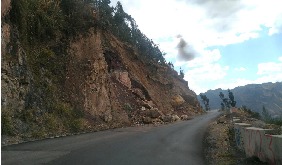
Ilustración 2: Presencia de derrumbes en laderas – Afectan el Pavimento Flexible (Fuente: Propio)
