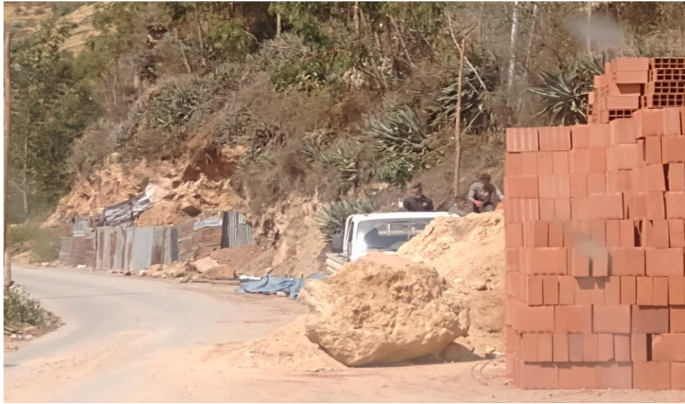
Ilustración 6: Presencia de derrumbes en laderas – Afectan el Pavimento Flexible (Fuente: Propio)
