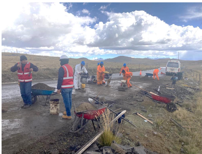
Ilustración 16: La falta de mantenimiento puede acelerar el deterioro del pavimento, Carretera Pasco – Yanahuanca (Fuente Propio)
