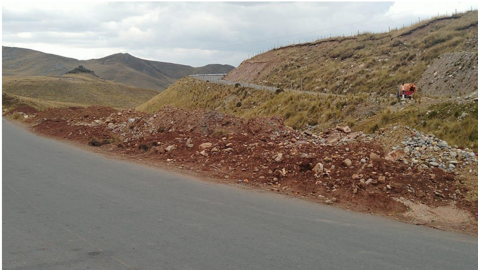
Ilustración 5: Presencia de material excedente (Fuente: propio)
