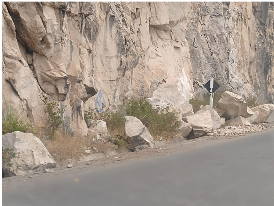
Ilustración 1: Presencia de derrumbes en laderas – Afectan el Pavimento Flexible (Fuente: Propio)
