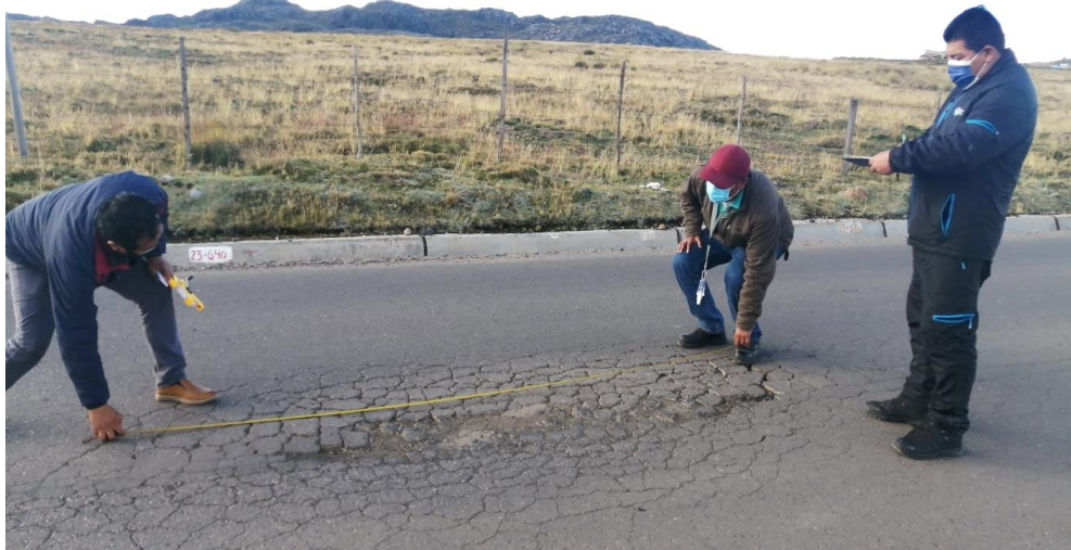
Ilustración 7: Evaluación del Estado del Pavimento Progresiva 23+640 (Fuente: Propio)
