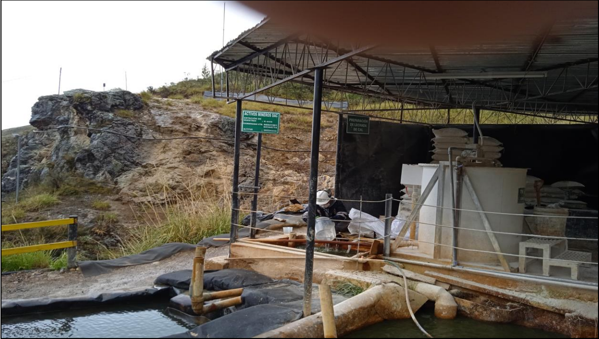
Fotografía N° 001: Vista de los componentes de la planta de tratamiento Azalía
