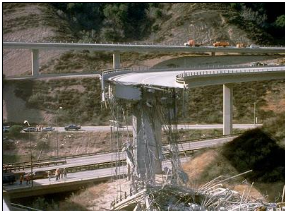
Figura 6. Colapso de un vano del puente N° 53-1964F en el intercambio vial de la autopista interestatal N° 5 con la ruta estatal N° 14 (Ramp M). (Obtenida de: https://sites.google.com/site/widowersbenches/mountains/history/a-geologically-active-region---the-1971-sylmar-quake-1994-northridge-quake )
