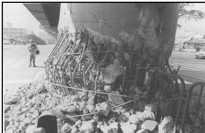
Figura 18. Falla de columna de la Vía expresa Hanshin, causado por el empalme de refuerzo en una misma sección en el Sismo de Kobe 1995 (Priestley M, 1996)
