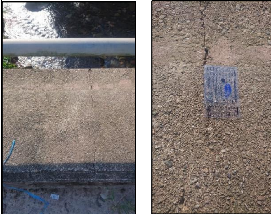
Figura 50. Grietas en la superficie de la Vereda del Puente Nochoz
