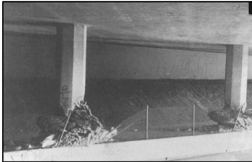
Figura 17. Falla por aplastamiento del concreto en columnas del puente Creek Canyon Channel en el Sismo de Northridge 1994 (Priestley M, 1996)
