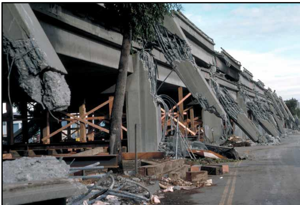
Figura 21. Falla de conexión viga-columnas en el Vía Ducto Cypres en el Sismo de Loma Prieta 1989 (Obtenida de: https://www.usgs.gov/media/images/cypress-viaduct-0 )
