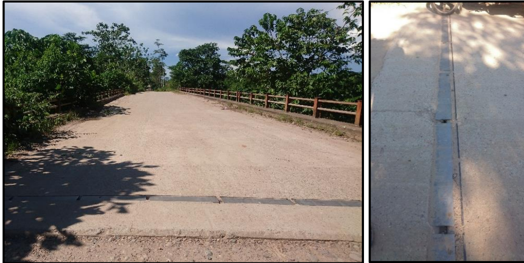
Figura 44. (Izquierda) Inicio de la losa del puente Nochoz sin losa de aproximación; (Derecha) Junta Metálica Obstruida en el apoyo izquierdo del puente Nochoz
