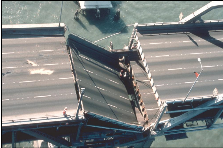
Figura 2. Falla de una sección del puente Bay Bridge (Obtenida de: https://www.flickr.com/photos/sanbeiji/220645446/in/photostream/ )
