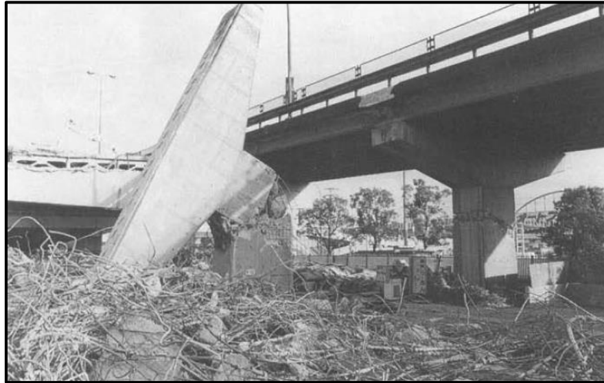
Figura 19. Falla por flexión a la mitad de la altura del pilar debido a la terminación prematura del refuerzo longitudinal, Sismo de Kobe 1995 (Priestley M, 1996)
