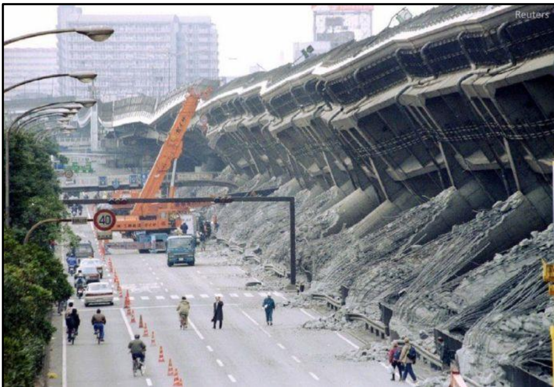
Figura 11. Falla de la autopista Hanshin en el Sismo de Kobe 1995 (Obtenida de: https://japon-secreto.com/el-gran-terremoto/ )
