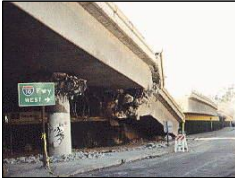
Figura 9. Colapso del Carril y daño al pilar en el cruce a desnivel entre Cienega Blvd y Venice Blvd. (Obtenida de: https://www.fhwa.dot.gov/publications/publicroads/94summer/p94su26.cfm )
