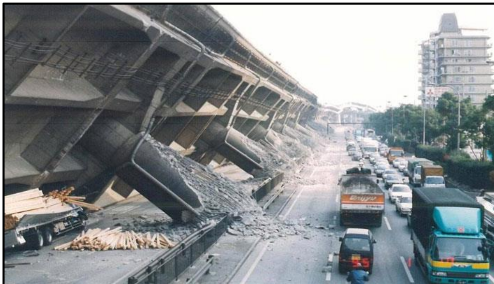
Figura 16. Falla a flexión en la Base de las columnas del puente Hanshín en el Sismo de Kobe 1995.
