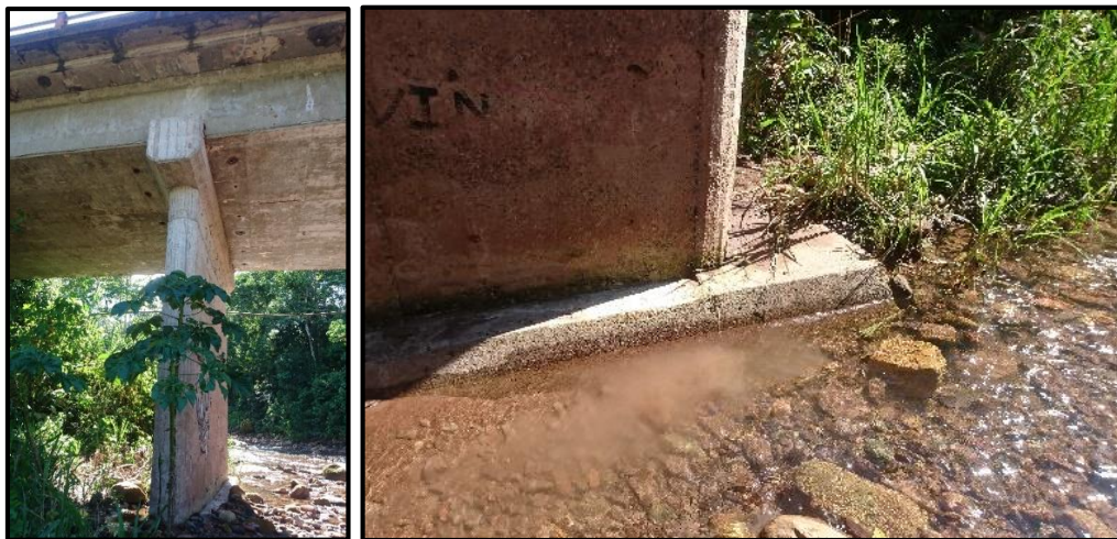
Figura 47. (Izquierda) Pilar central del Puente Nochoz; (Derecha) Base del Pilar con principios de socavación
