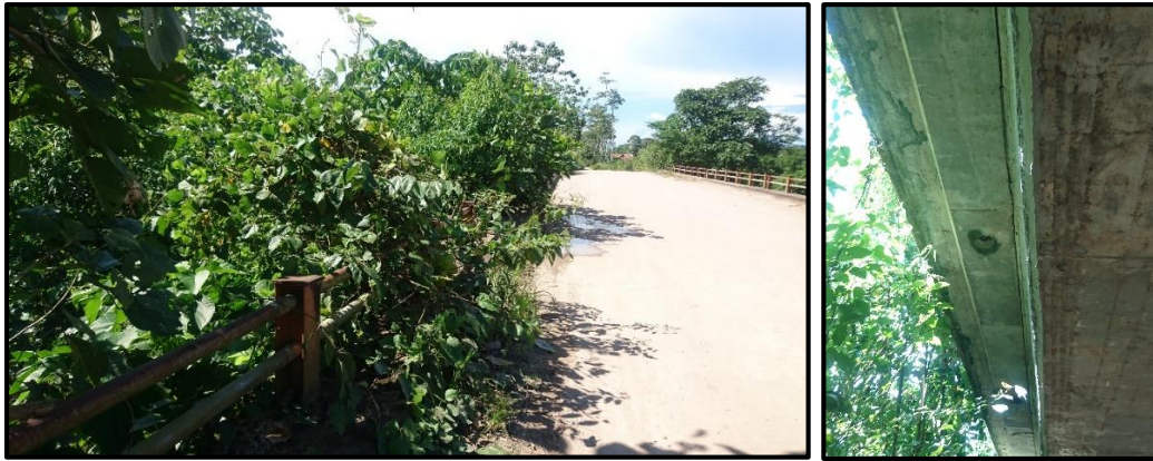
Figura 48. (Izquierda) Vereda Izquierda obstruida por el crecimiento de la vegetación; (Derecha) Tubería de Drenaje Obstruida
