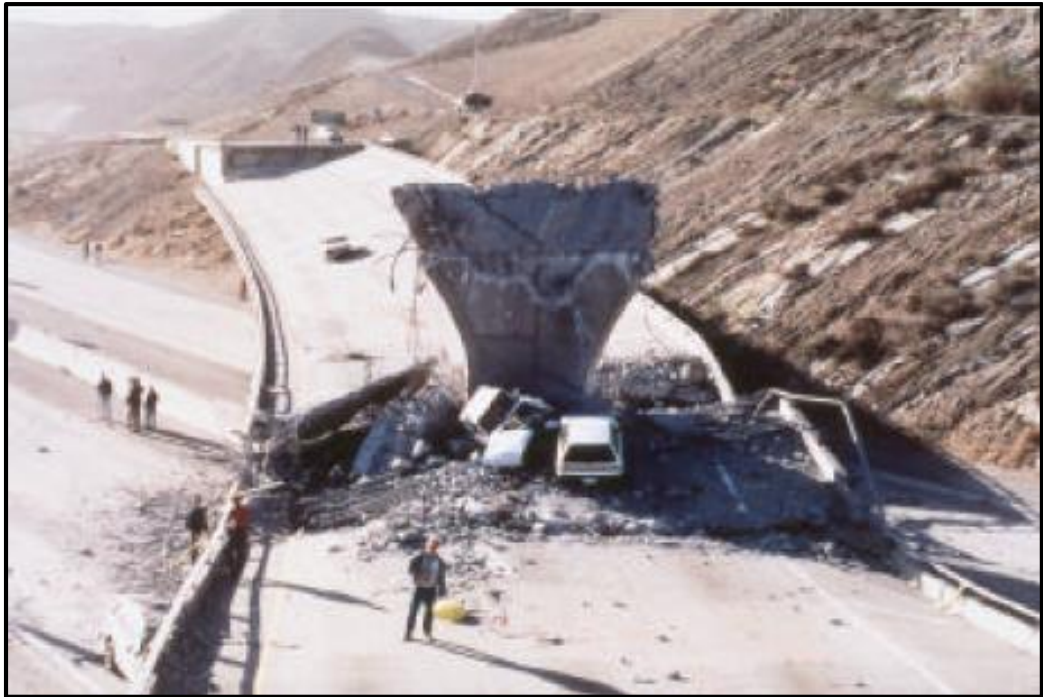
Figura 5. Colapso de un vano del puente N° 53-1960F en el intercambio vial de la autopista interestatal N° 5 con la ruta estatal N° 14 (Ramp C). (Priestley M, 1996)
