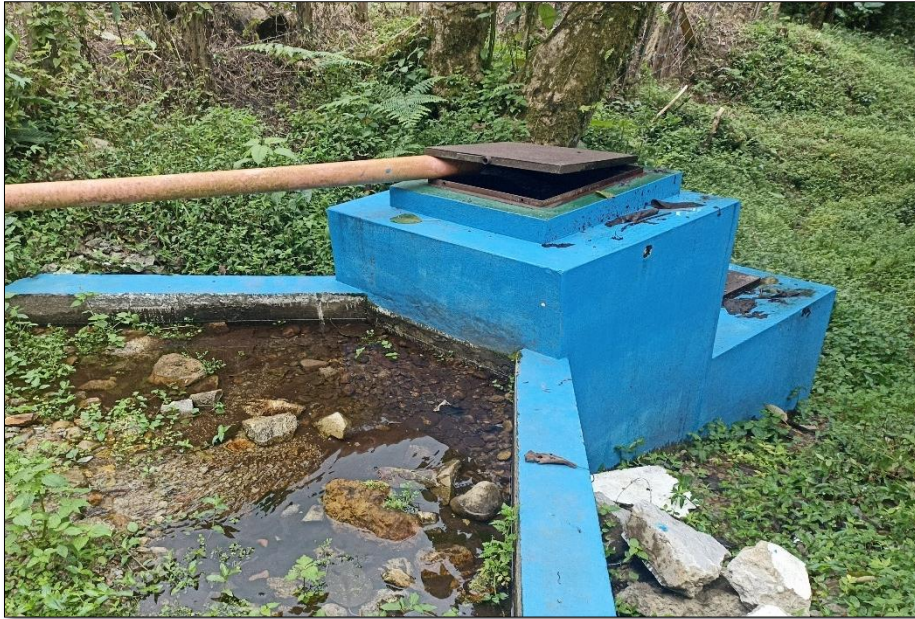
Foto N° 1. -Captacion de manantial del sistema de abastecimiento de agua del anexo de Tambo Pituca
