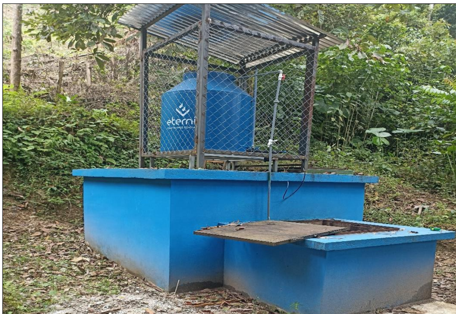
Foto N° 2. -Reservorio del sistema de abastecimiento de agua del anexo de Tambo Pituca
