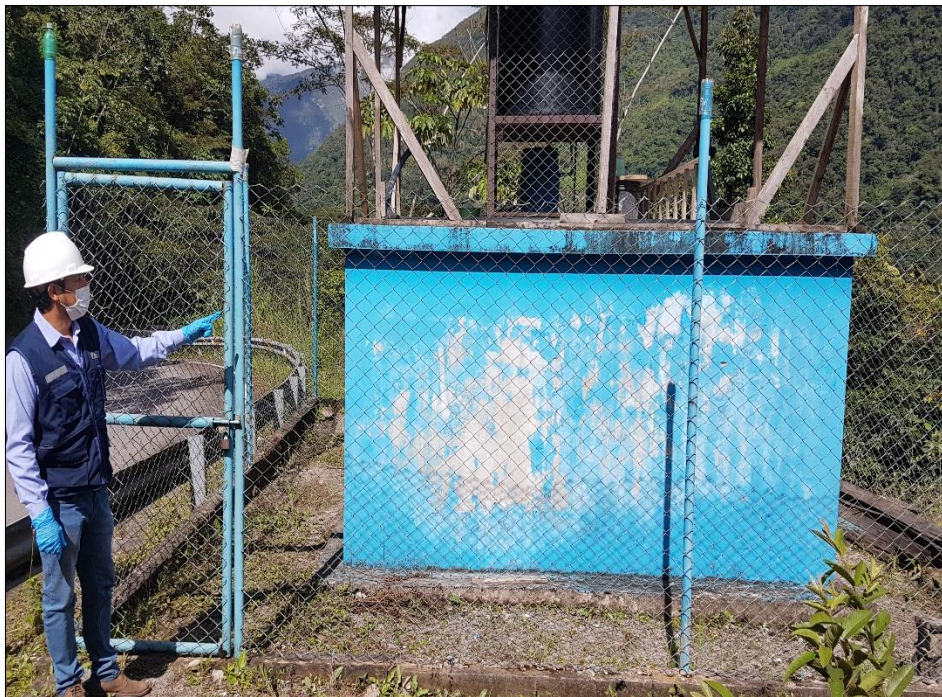
Foto N° 4.- Reservorio del sistema de abastecimiento de agua del Anexo de Mesapata
