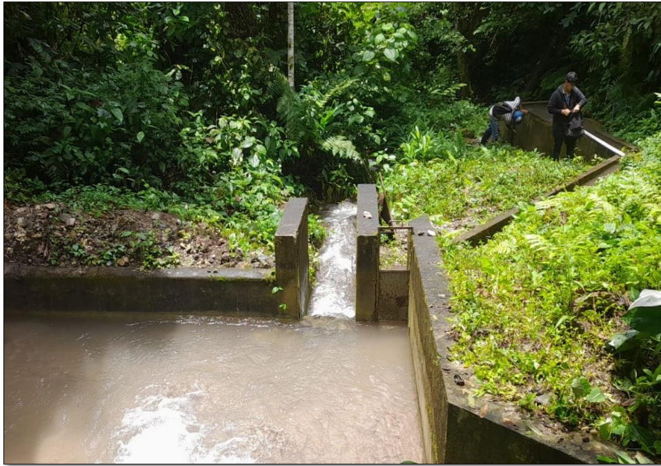
Foto N° 3.- Captacion de quebrada del sistema de abastecimiento de agua del Anexo de Mesapata
