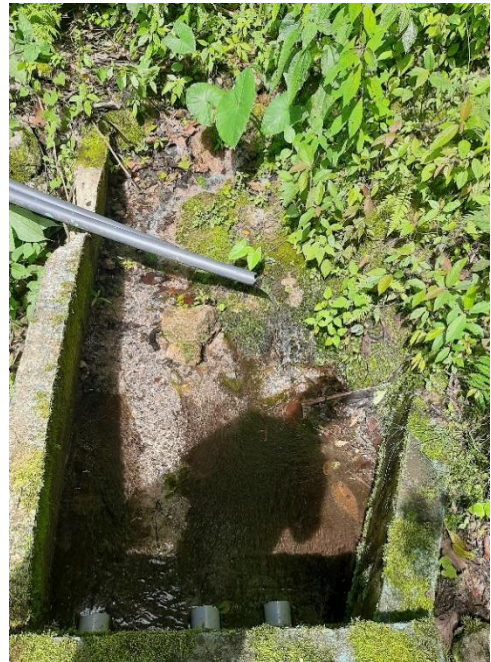
Fotografía N° 2: Captación de Machicura
