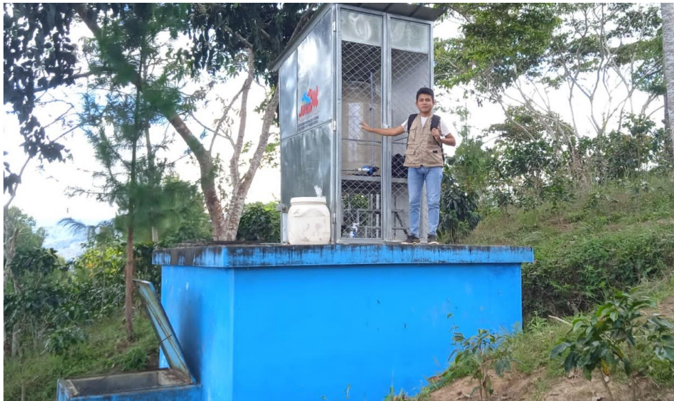
Figura 6: Reservorio del sistema de agua anexo Santa Rosa de Yapaz
