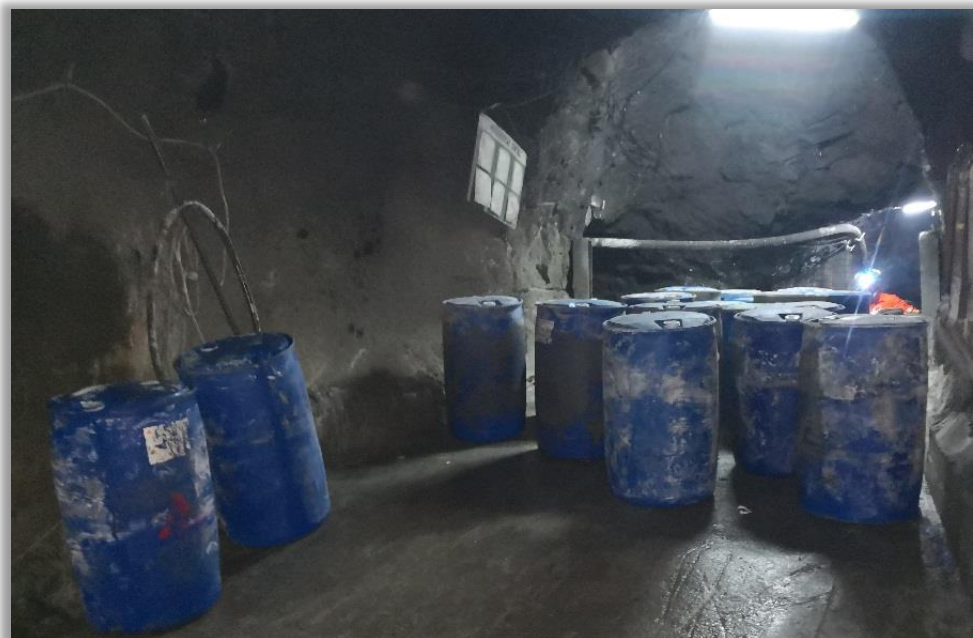
Figura 42. Almacenamiento de Cilindros en la Cámara de Aditivos (Nv. 970) Fuente: Elaboración Propia.
