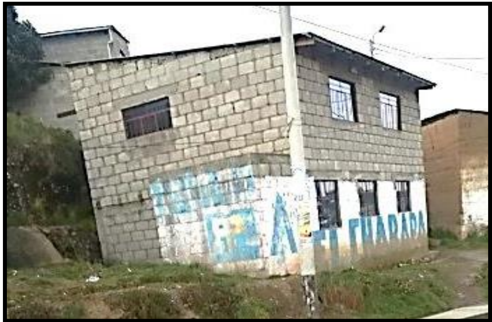
Figura 2: Vivienda con muros sin bordes arriostrados en ambas direcciones en el segundo nivel, ubicado en Urbanización Barrio Buenos Aires.
