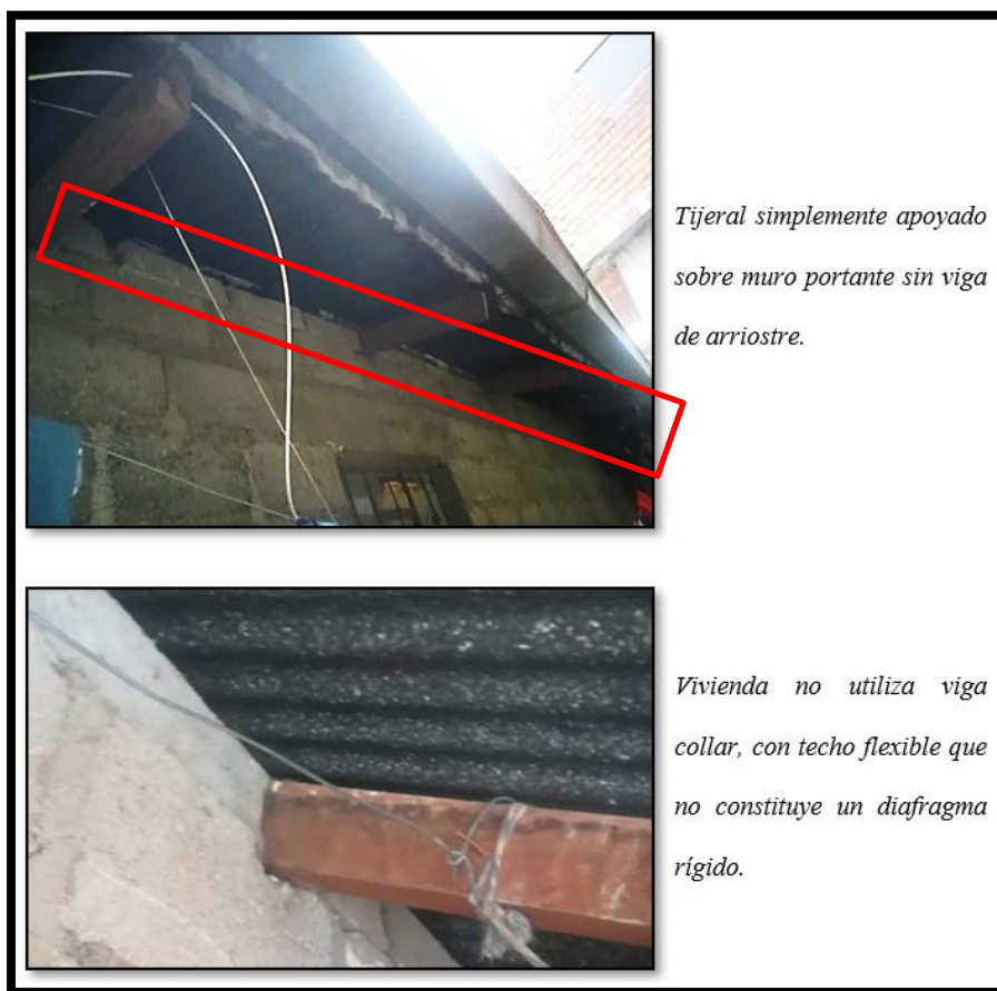
Figura 4: Viviendas no utilizan vigas collar en el segundo nivel y superiores
