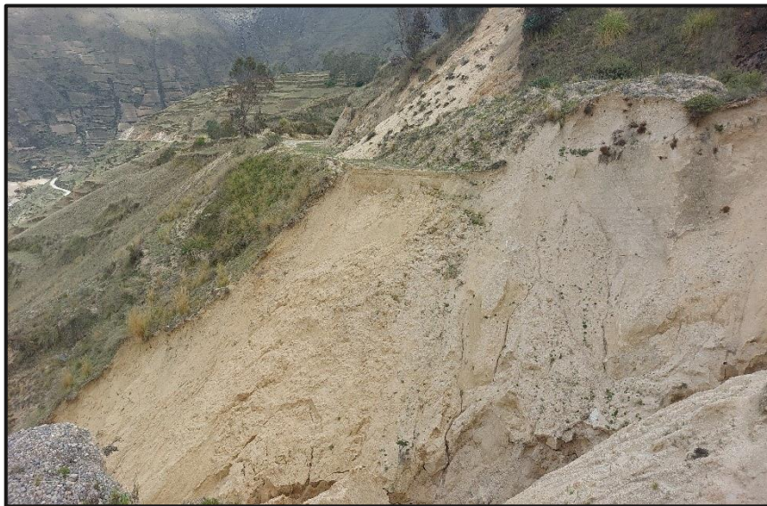
Ilustración 1: Progresiva 40+590 al km 40+630, lugar donde se evidencia la erosión y deslizamiento de la plataforma (Fuente: propio)
