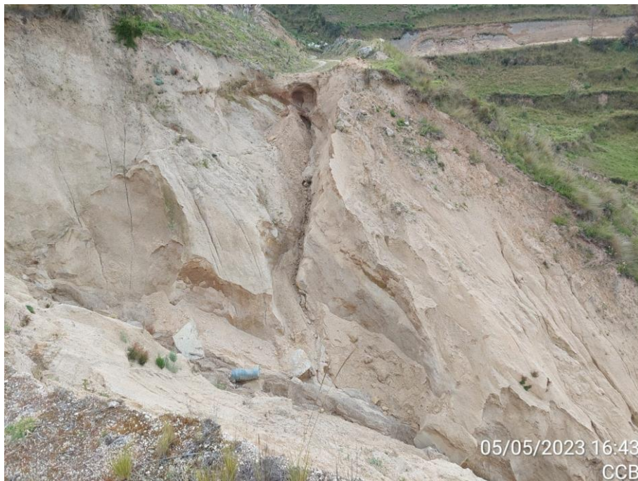
Ilustración 13: Pérdida de la plataforma por deslizamiento de talud (fuente: Propio)
