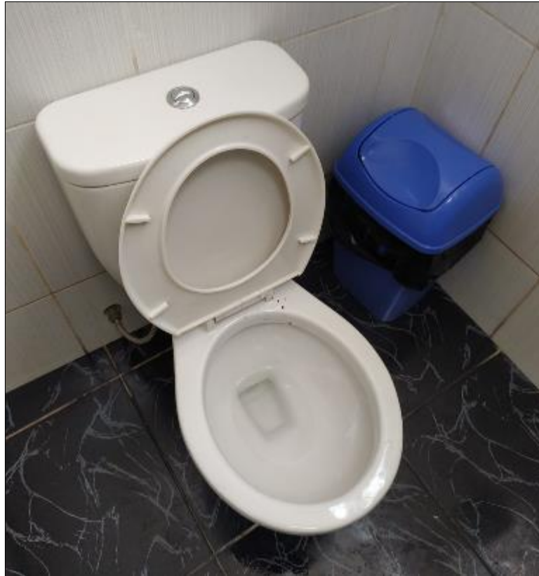
Fotografía 05.- Inodoros existentes en la edificación
