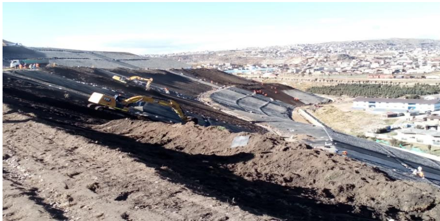
Fotografía 13: Daños en la geomembrana producto de maquinaria en campo
