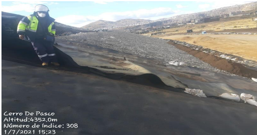
Fotografía 19: Verificación de daños en Geosintéticos
