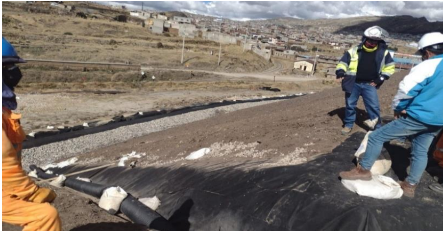
Fotografía 3: Cama y eje de tubería de descarga.
