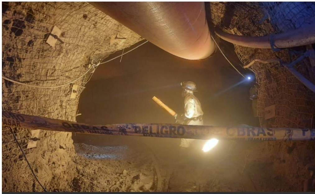
Figura 70. Señalizaciones de seguridad.
