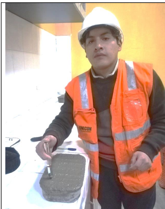
Foto N°21: Toma de muestras en moldes para realizar ensayos de resistencias tempranas en fraguado.
