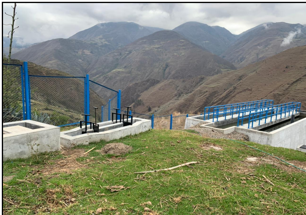
Vista del desarenador de la planta de tratamiento implementado en el centro poblado de Antapirca
