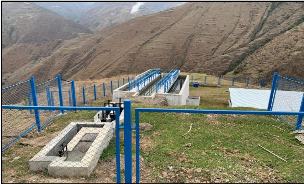
Vista de los componentes de la planta de tratamiento implementado en el centro poblado de Antapirca
